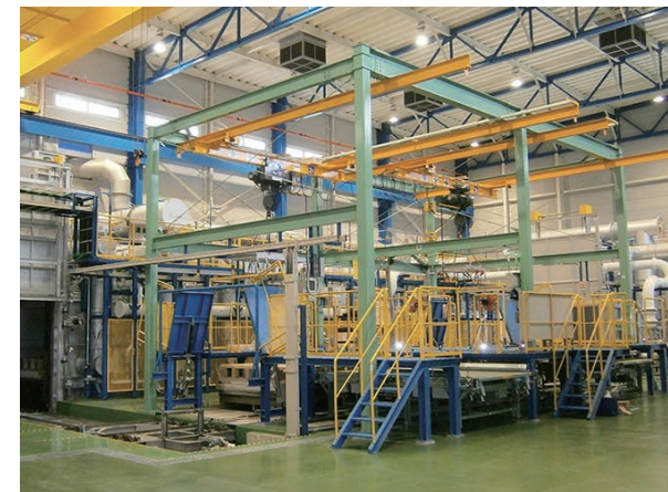
低濃度PCB処理設備
