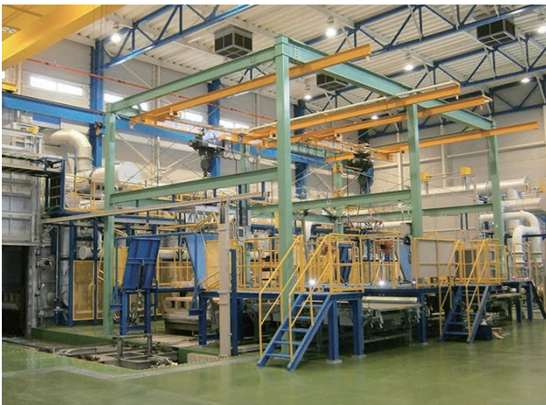
低濃度PCB処理設備
